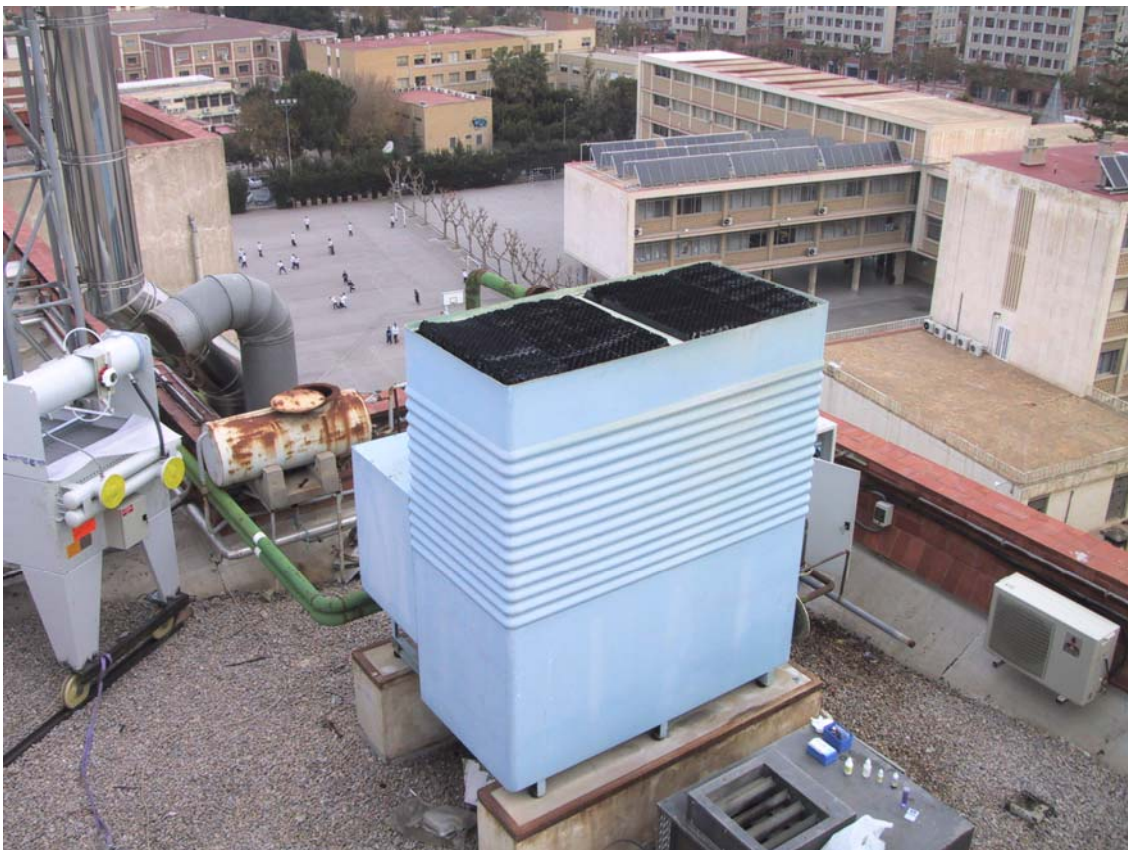
Figura 2. Torre de refrigeración ubicada en casco urbano
